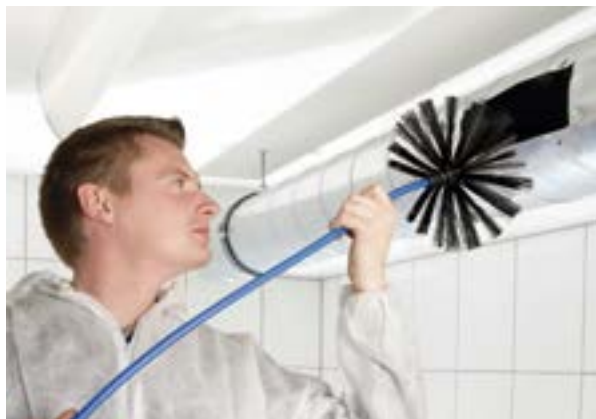
Borstelreiniging met de flexibele buigas ventilatie
