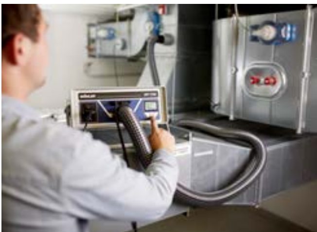
Meetopstelling dichtheidsklasse ventilatiesystemen conform NEN-EN 16798
