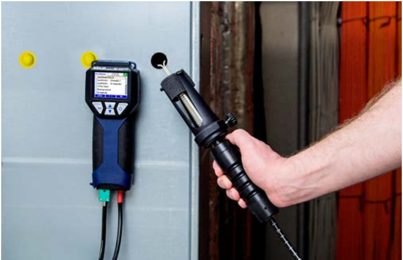
Traverse meting bij rechthoekig leidingwerk met de Wöhler DC 410FLOW en pitotbuis type S
